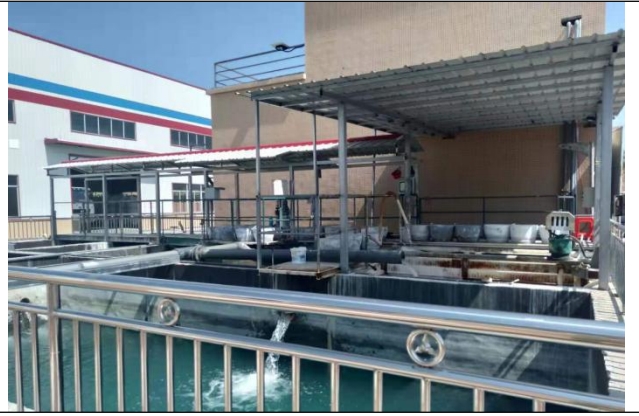
清洗废水处理站
