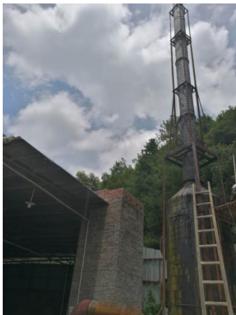
脱硫除尘处理设施
