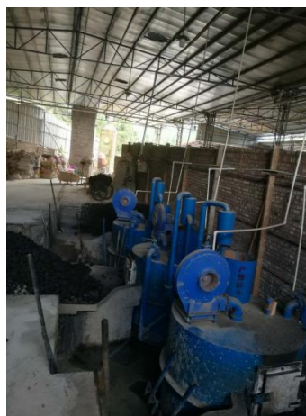
半煤气发生炉
